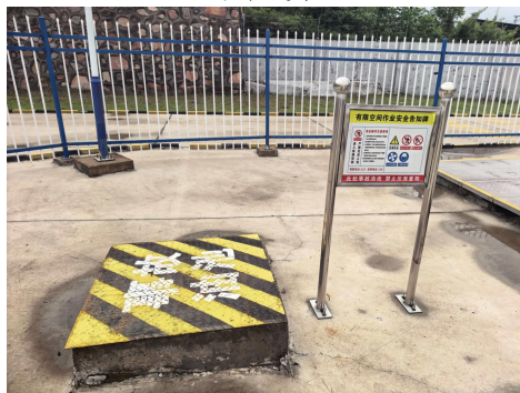
主变事故油池
