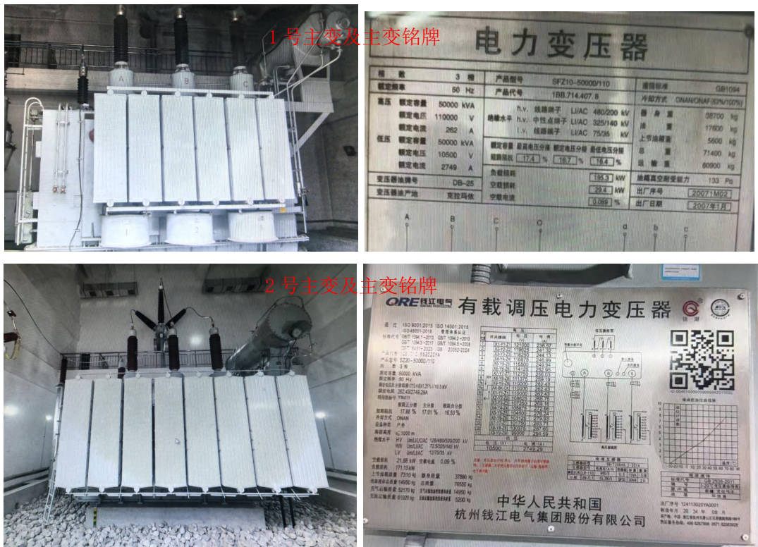
图 3-2 泰山 110kV 变电站站内主要设备设施照片
