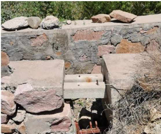
延庄 2#斗口分水闸
